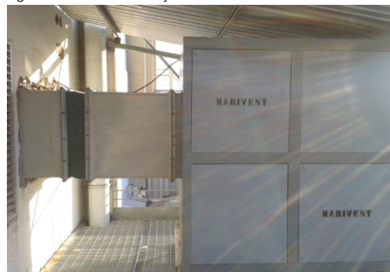
Figura 3 – Caixas de Ventilação
